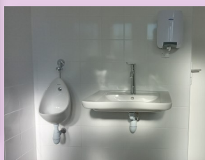
Intérieur de la cabine de toilettes avec une cuvette de WC, un urinoir et un lavabo.
